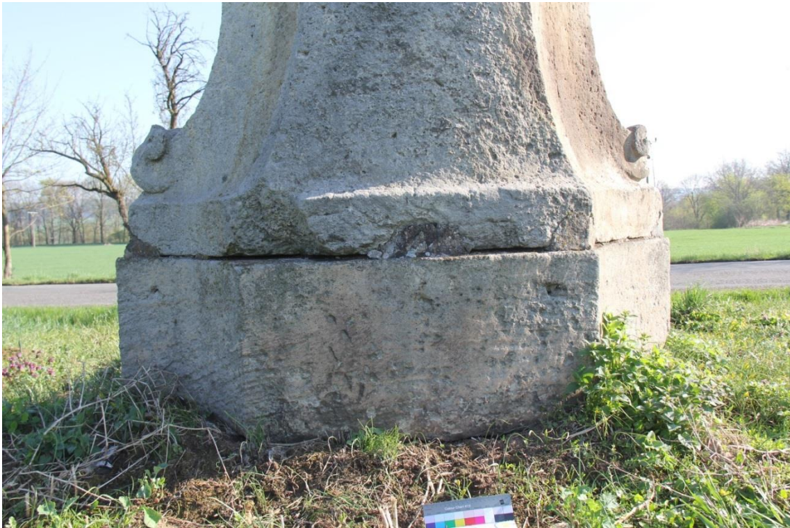
Obrázek 25 Detail chybějící výplně spáry a mechanické poškození hrany.
