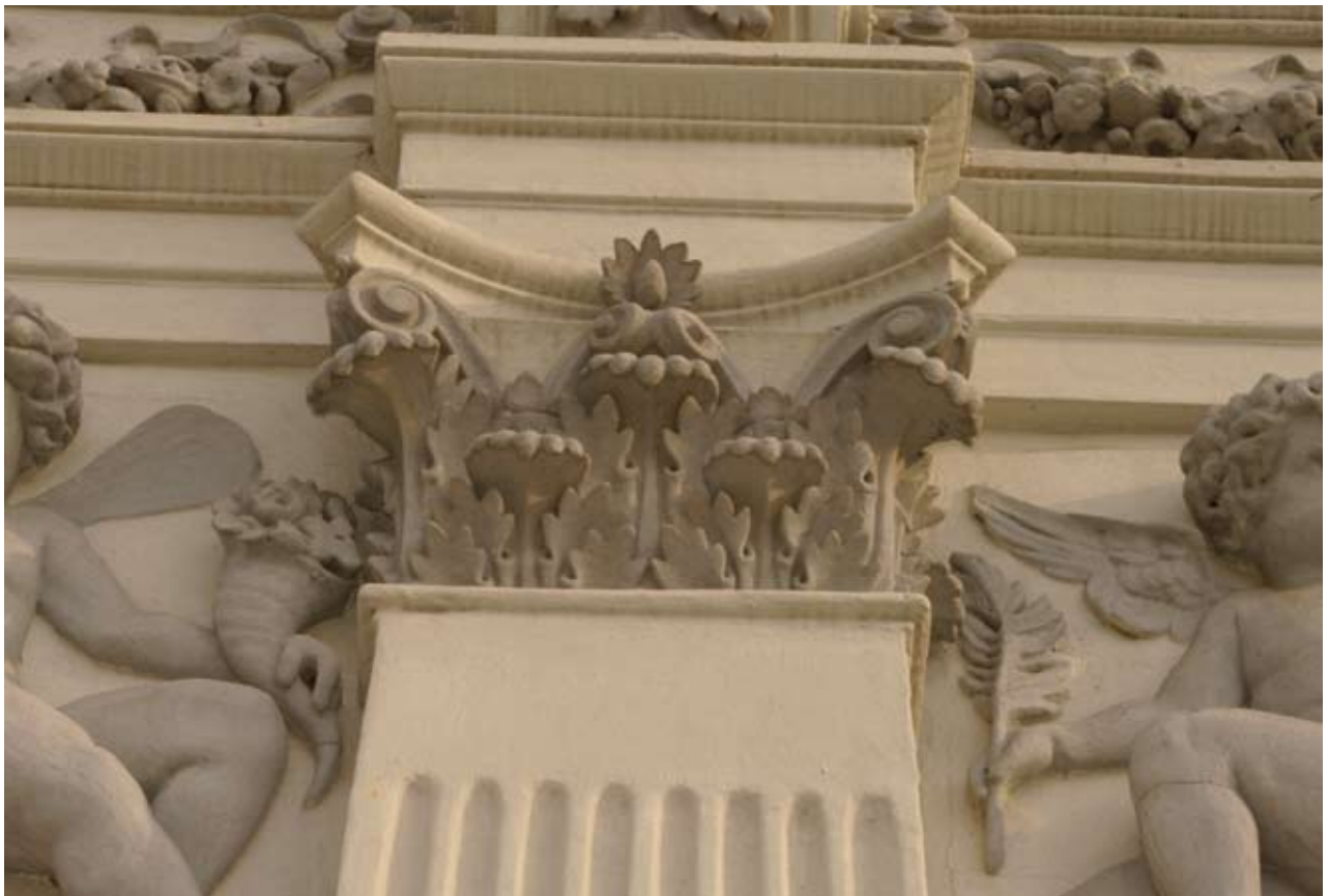
Obr. 152: Pohled na korintskou hlavici a část kanelovaného dříku pilastru v druhém nadzemním podlaží středního dílu jižního průčelí (Kudrnovský, 2015).
