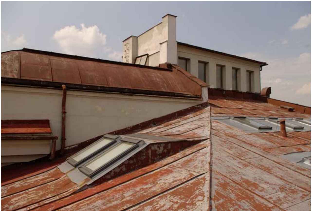
Obr. 180: Pohled na jihovýchodní část střechy Hankova domu střešní pavilon a část báňové střechy (Kudrnovský, 2015).
