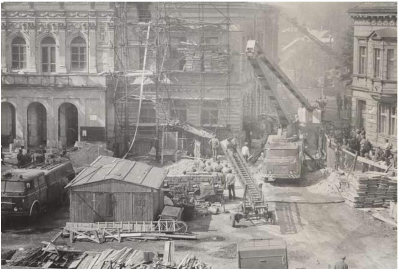
Obr. 119: Obnova Hankova domu, mezi lety 1969-1974 (5531/99, Hankův dům, Geislerova sbírka, Městské muzeum DKnL).
