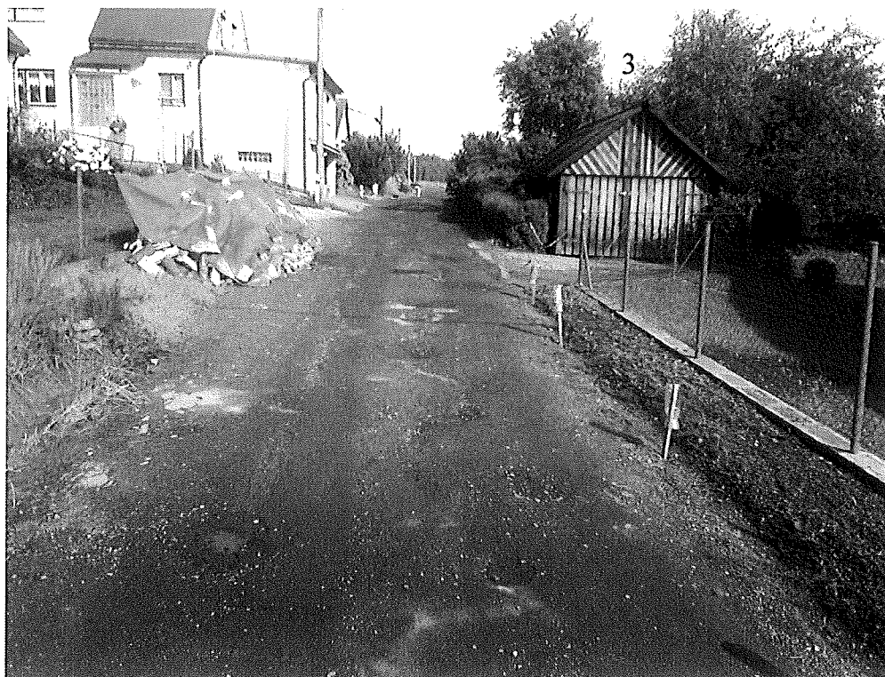
F3: 0,150+ km; nezpevněný povrch, výmoly, plošné deformace
