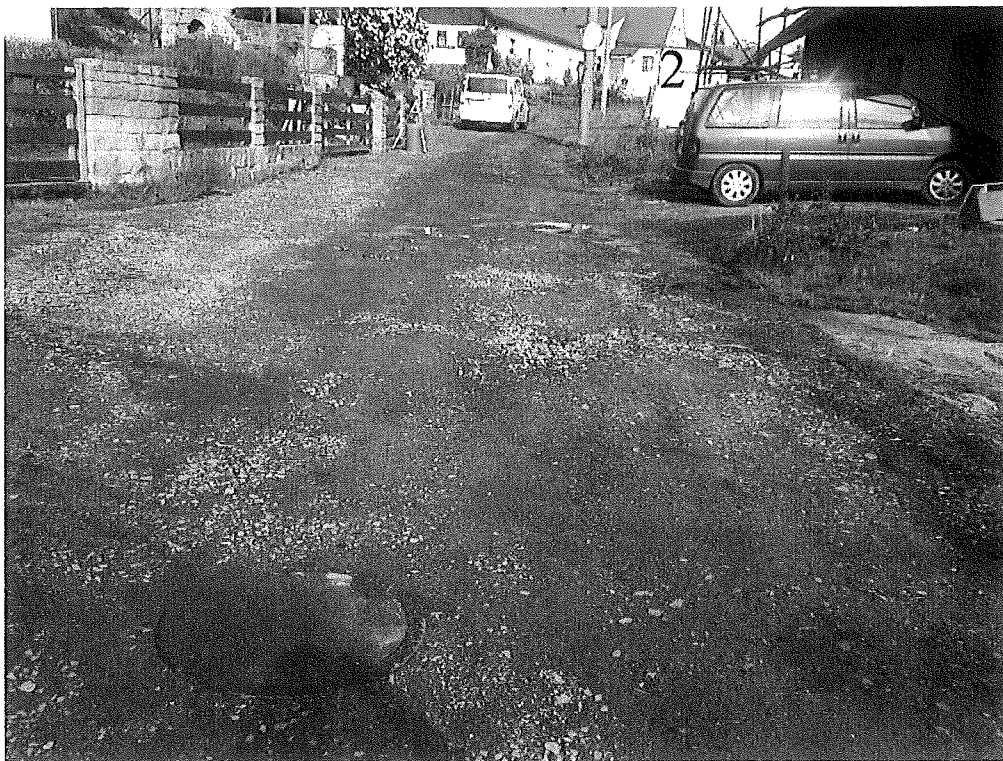
F2 0,100+ km; nezpevněný povrch, plošné deformace
