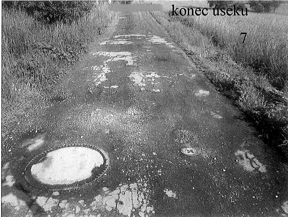
F5: konec úseku, 0,500 km; částečně pevněný povrch, plošné deformace
