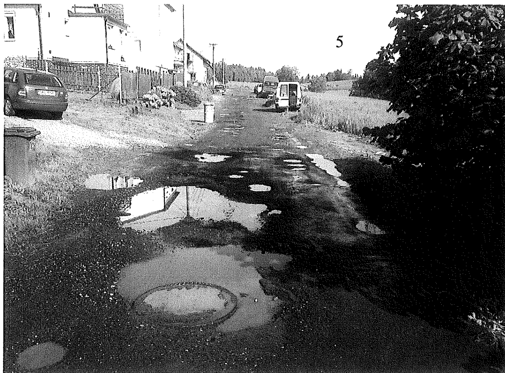
F4: 0,200+ km; nezpevněný povrch, výmoly, plošné deformace
