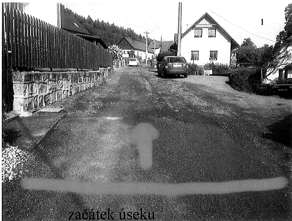
F1: začátek úseku, nezpevněný povrch, plošné deformace
