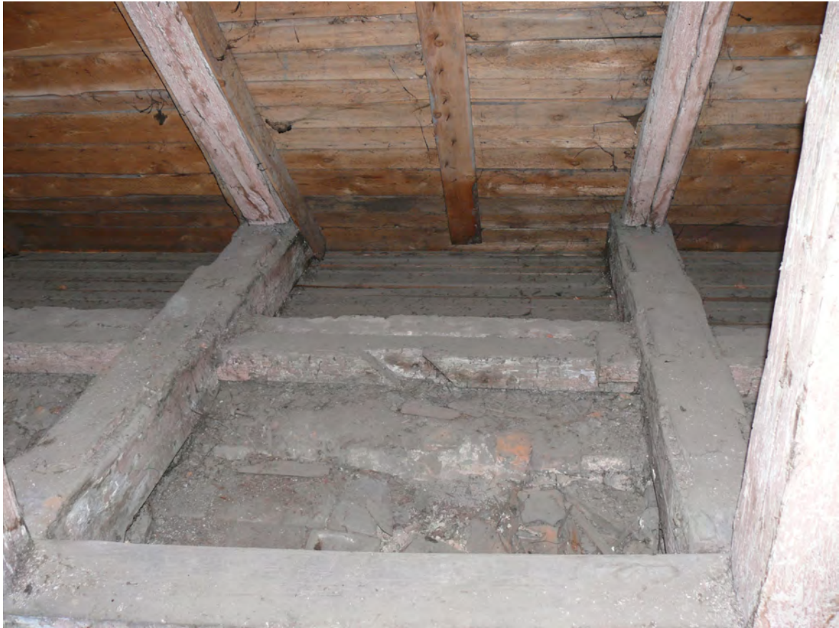
105 Druhotně použité prvky v severní patě krovu
