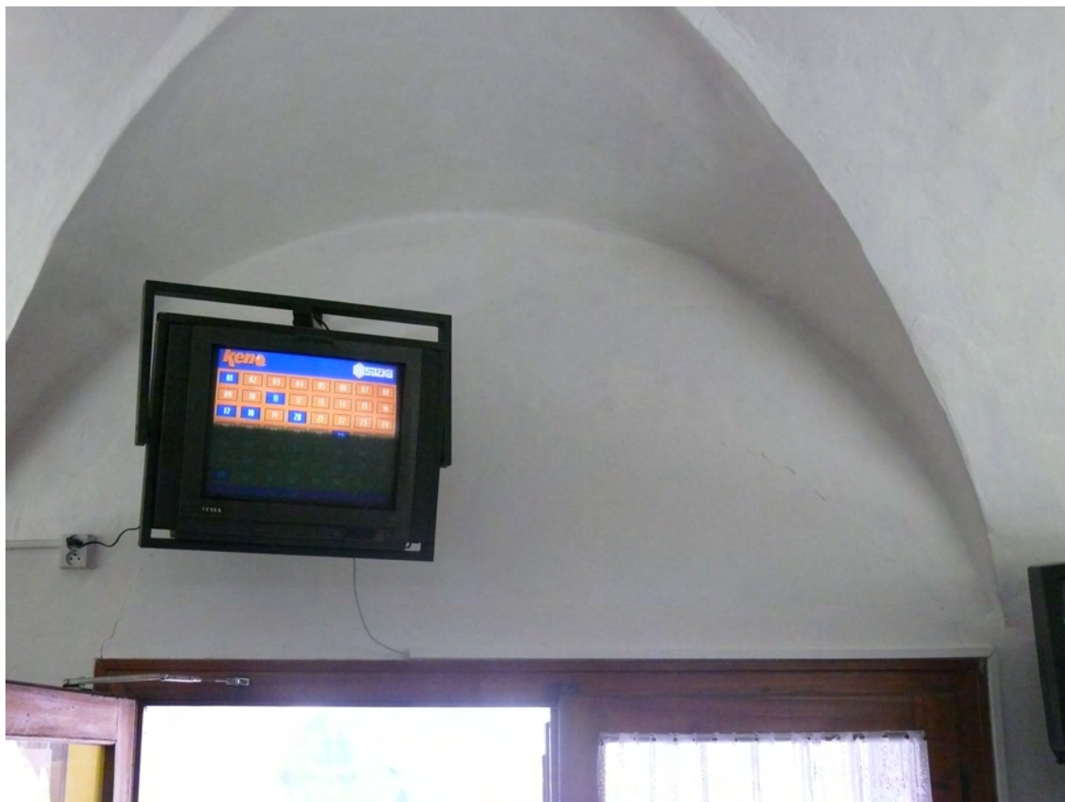
043 Jižní čelo s prasklinou záklenku
